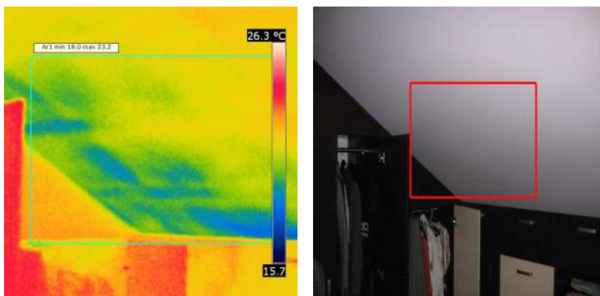
Rys. 12 Termogram wadliwie wykonanej izolacji dachu
