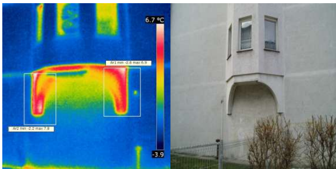
Rys. 19 Termogram nieizolowanej podpory żelbetowej wykusza
