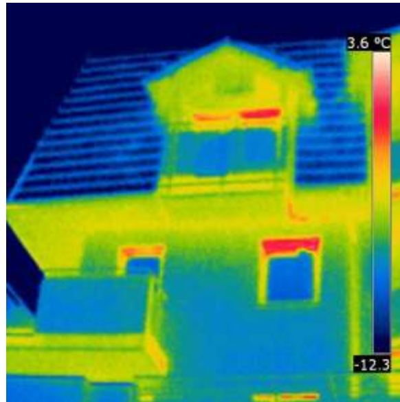
Rys. 1 Termogram budynku wielorodzinnego
